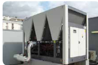
CHAUFFAGE ET CLIMATISATION
